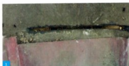
3. Pročistit drážku pro plotnu č.1, pokud nevychází v místě mezera dřevěného základu (bednění).
